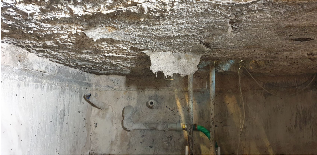
Fot. 11. Widok stropu zbiornika z pozostałością powłoki ochronnej
