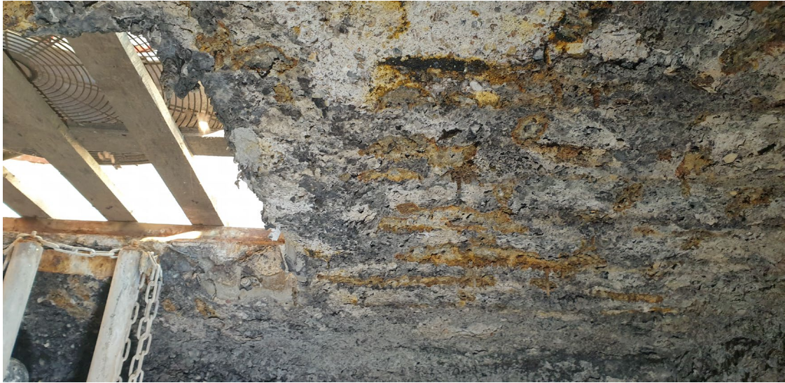
Fot. 2. Widok korozji stropu zbiornika, korozja prętów zbrojeniowych
