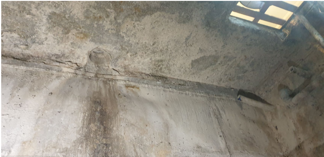
Fot. 12. Widok wnętrza zbiornika, korozja betonu na stropie
