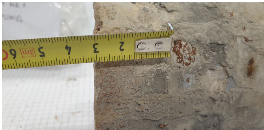
Fot. 22. Widok zbrojenia w próbce nr 1, grubość otuliny od zewnątrz 30mm
