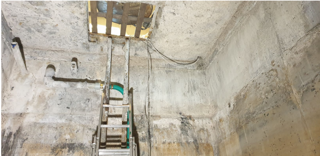
Fot. 8. Widok wnętrza zbiornika, korozja betonu na stropie, folia ochronna na ścianach
