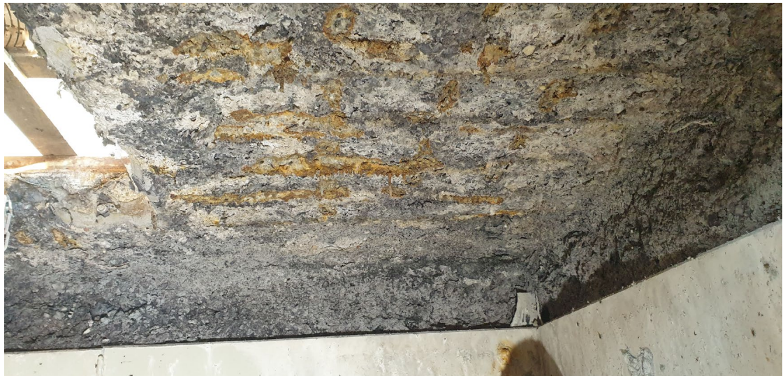
Fot. 3. Widok korozji stropu zbiornika, korozja prętów zbrojeniowych
