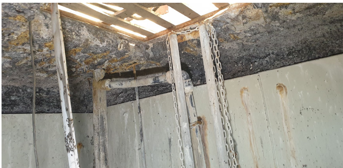
Fot. 1. Widok korozji stropu zbiornika, płyty PEHD na ścianach
