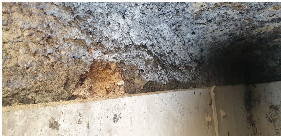
Fot. 4. Widok korozji betonu na ścianie (miękką maź) ponad nową okładziną z płyt PEHD
