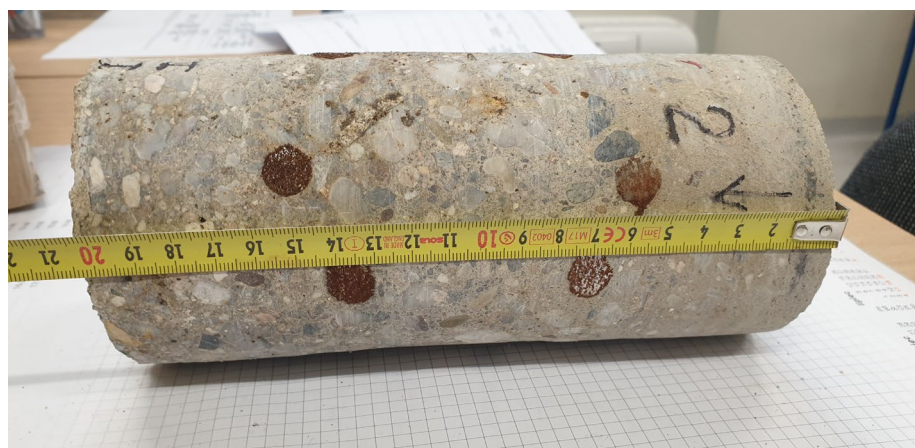
Fot. 23. Widok zbrojenia w próbce nr 2, grubość otuliny od wewnątrz 40 mm, od zewnątrz 50mm
