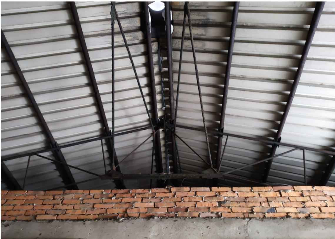
Fot. 1 Wiązarkratownicowy ramy liczne ogniska korozji, nieszczelność pokrycia dachu przy wywietrzaku
