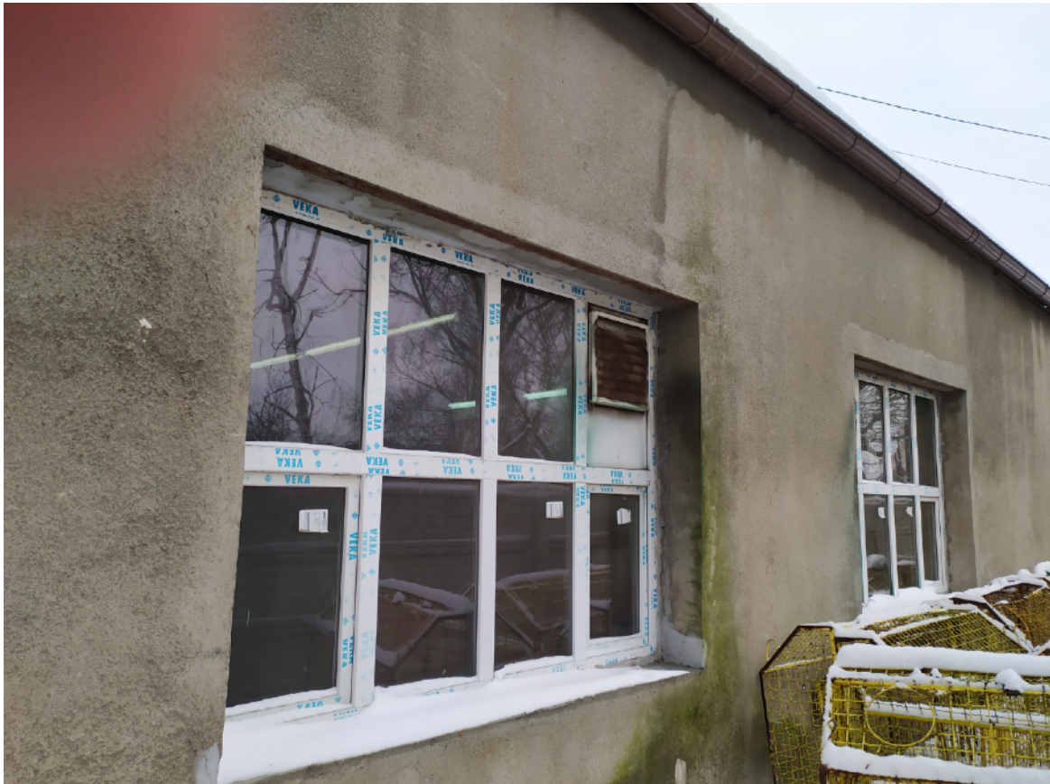
Fot. 4 Część murowana budynku – wykwyty glonów na ościeżnicach okiennych
