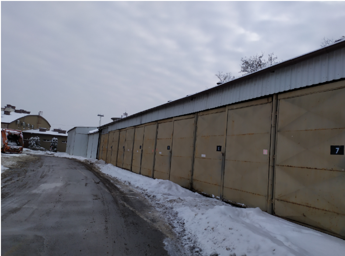
Fot. 2 Elewacja frontowa – liczne ogniska korozji bram stalowych
